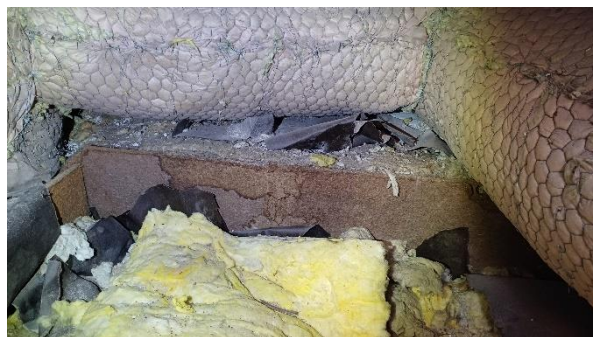
Kuva 56. Kuvaamataidonluokan yläpuolisessa yläpohjatilassa silmällä nähtäviä kosteusvauriojälkiä sekä yläpohjatilaa kuulumatonta rakennusjätettä
