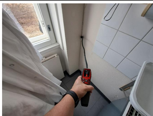
Kuva 44. Fysiikka- kemialuokan seinässä pilarin ja seinän liittymäkohdassa halkeama ja ilmavuotoa.
