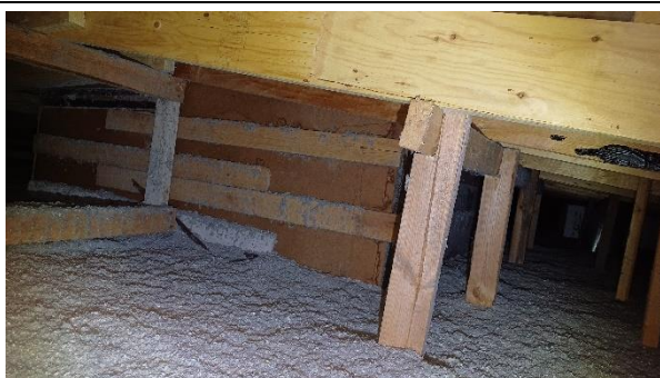
Kuva 51. Luokkasiiven yläpohjatilassa kattoikkunan rakenteissa vesivuotojälkiä
