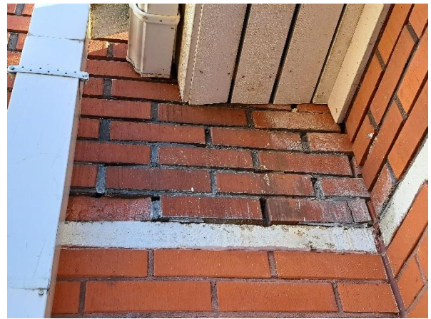
Kuva 36. Teknisen työn päädyssä on jäätyksen aiheuttamaa rapaumaa.
