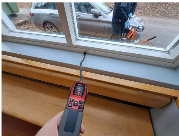
Kuva 45. Aulan ikkunapenkistä havaittiin ilmavuotoa sisäilmaan.
