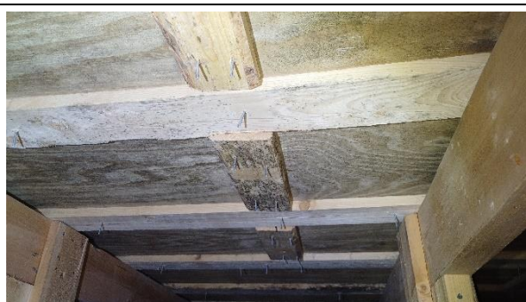
Kuva 50. Teknisen työn tilan yläpuolella olevassa yläpohjatilassa puurakenteissa silminnähtävää tummentumaa/mikrobikasvustoa
