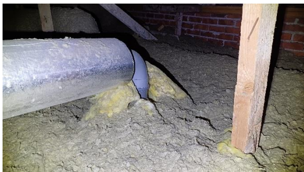
Kuva 55. Ruokalan yläpuolisessa yläpohjatilassa viemärin tuuletusputki lämmöneristetty puutteellisesti
