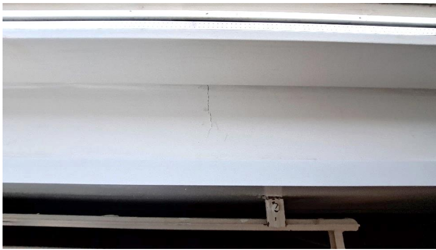
Musiikkiluokan ikkunapenkeissä halkeamia.
