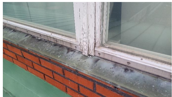
Kuva 38. Liikuntasalin ruokalan puoleiset ikkunat teknisen käyttöön ohittaneita.
