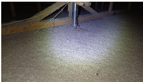
Kuva 53. Luukkasiiven antennin jalan kohdalla pieni kosteusvaurioalue
