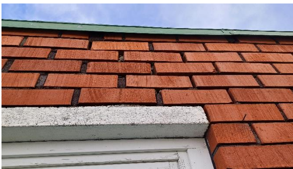
Kuva 37. Liikuntasalin ruokalan puoleiset ulkoseinän tiilisäumat huonokuntoisia.
