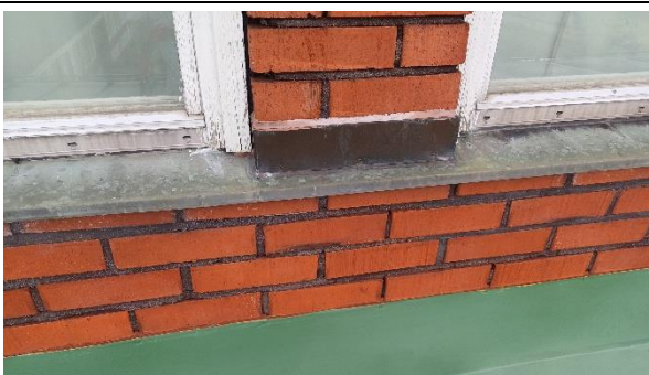
Kuva 39. Liikuntasalin ruokalan puoleiset ulkoseinän tiilisäumat huonokuntoisia.
