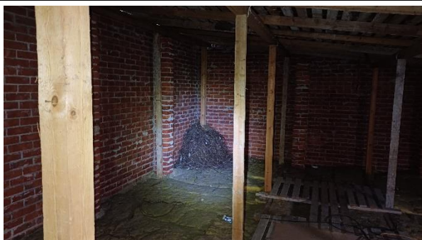
Kuva 57. Liikuntasalin yläpuolisessa yläpohjatilassa isohko linnunpesä
