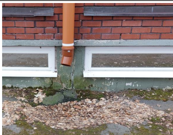
Kuva 8. Sadevesikaivo tukossa, sokkelissa kasvaa sammalta.
