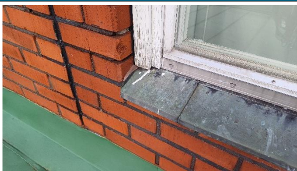
Kuva 41. Liikuntasalin ruokalan puoleiset ulkoseinän tiilisaumat ja ikkunaliittymät huonokuntoisia.
