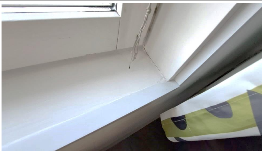
Musiikkiluokan ikkunapenkeissä halkeamia.
