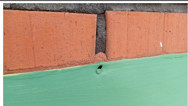
Kuva 40. Pellityksen ja sauman massauksissa on epätiiveyksiä.
