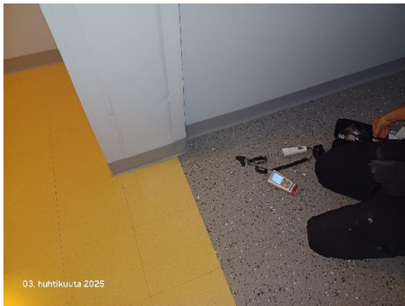
Kuva 25. Matalan osan käytävä, viiltokosteusmittaus pinnoitteen alta.
