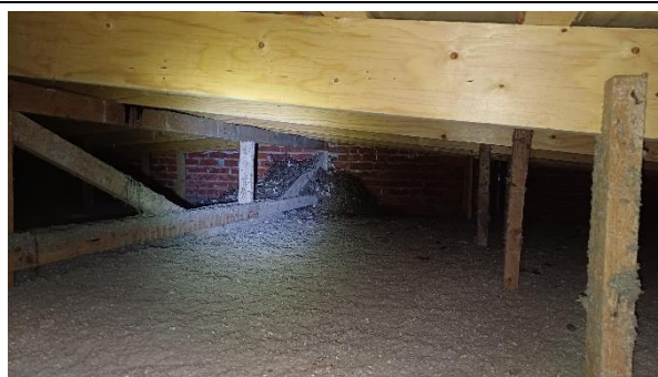
Kuva 52. Luokkasiiven yläpohjatilassa iso linnunpesä
